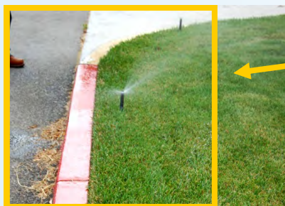
Rociadores viejos regando agua en la calle y vereda.
